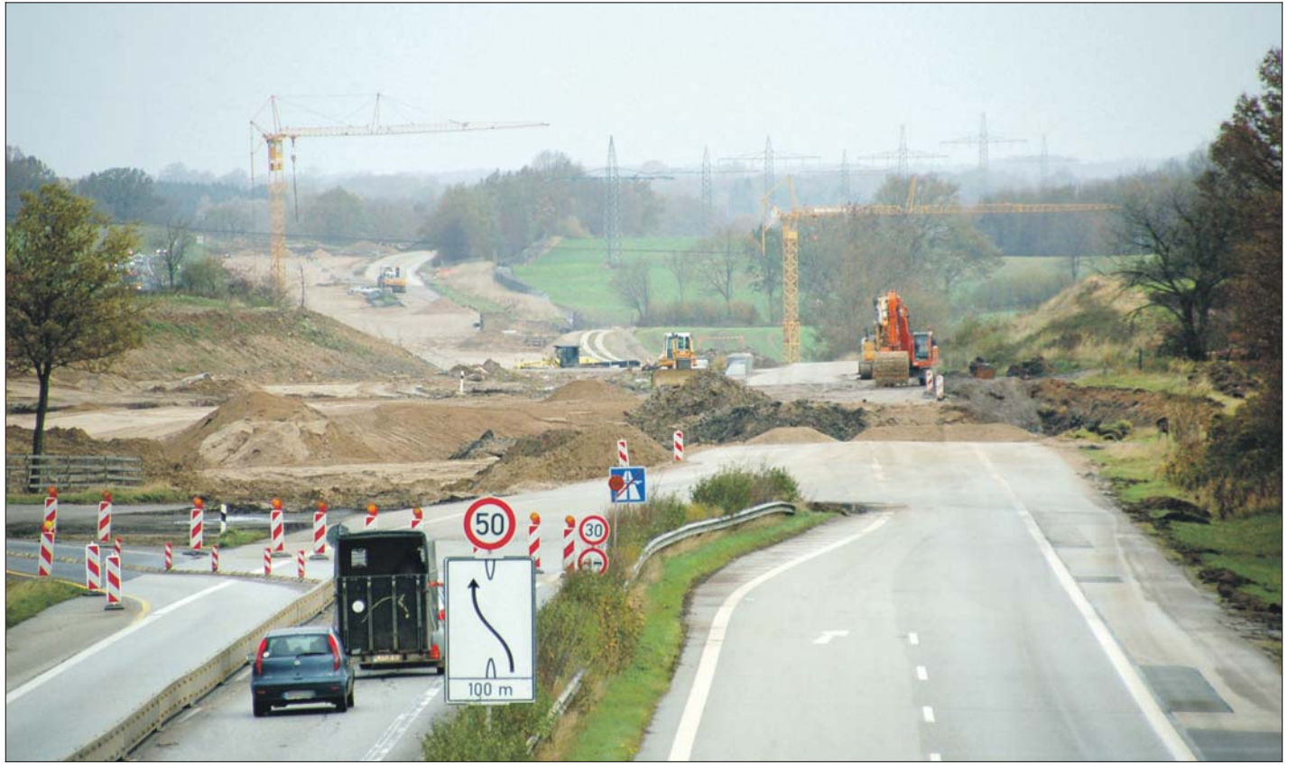
Blick auf die Baustelle: Der Verkehr wird über die Parallelstraße geführt, damit im Trassenbereich gearbeitet werden kann. Foto sel
